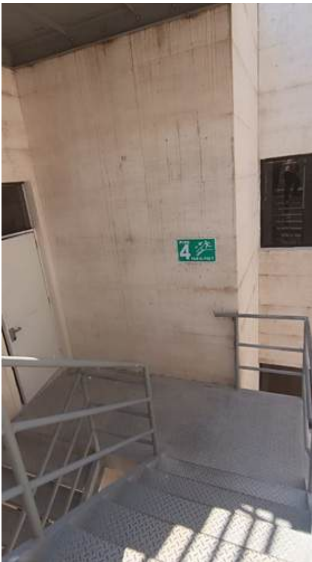
Señalética escalera de emergencia
