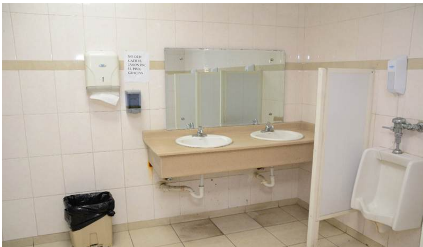
Baño de caballeros, lavamanos y orinal
